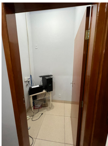
Imagem 5: Sala do Servidor sem climatização com fiação exposta, em desacordo com o Provimento n. 74/CNJ.
