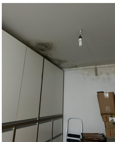
Imagem 9: Armários de armazenamento dos livros com infiltração no teto e paredes.
