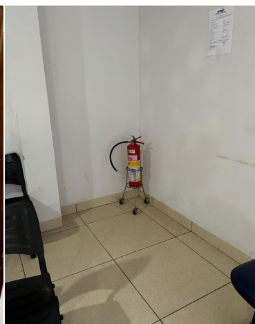
Imagem 6: Extintor de Incêndio, insuficiente e fora da validade.
