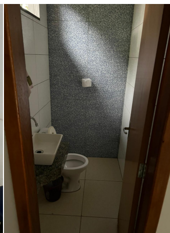
Imagem 7: Banheiro, sem acessibilidade para deficientes.
