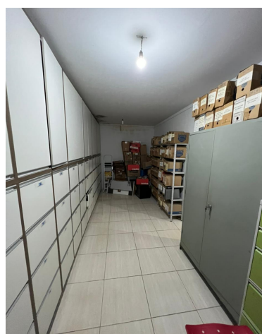
Imagem 10: Sala de armazenamento dos arquivos com vários pontos de infiltração.
