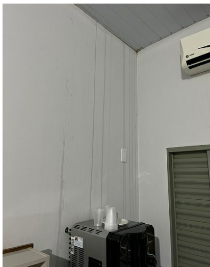
Imagem 4: Infiltração gravíssima ocorrida durante chuva
