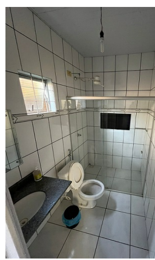
Imagem 6: banheiro sem acessibilidade para
