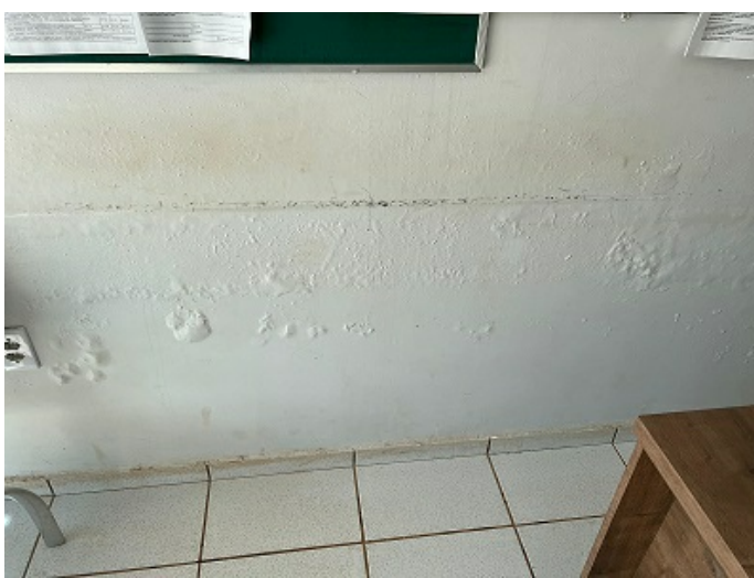
Imagem 5: Infiltração e mofo
