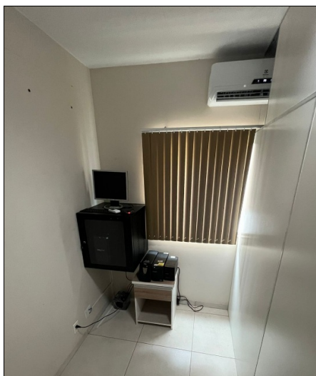
Servidor de rede instalado (Provimento 74 CNJ)
