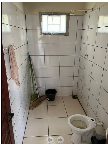
Banheiro sem acessibilidade
