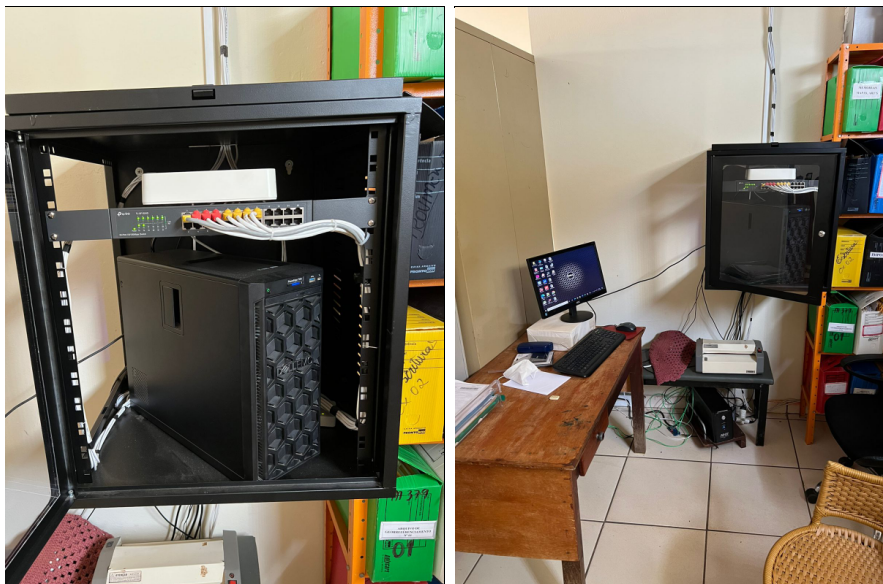
Servidor em local inadequado
