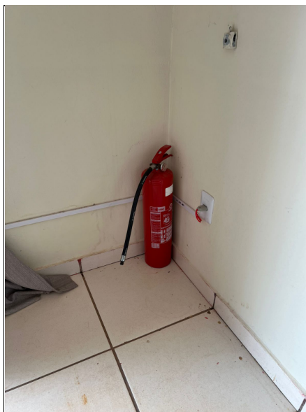
Extintor de incêndio alocado chão
