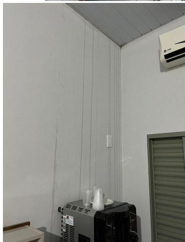
Imagem 8: Sala 1 (cabos soltos)
