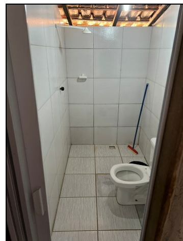
Banheiro não adaptado para PcD.
