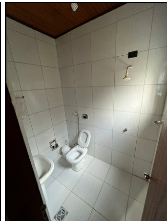
Banheiro não adaptado para PcD.
