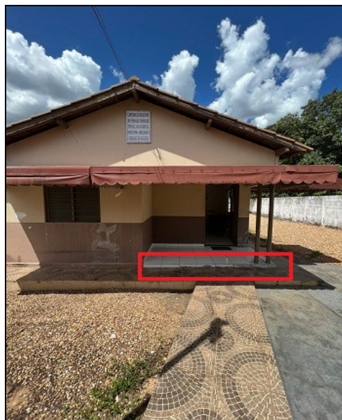
Entrada da serventia sem rampa de acesso para PcDs.
