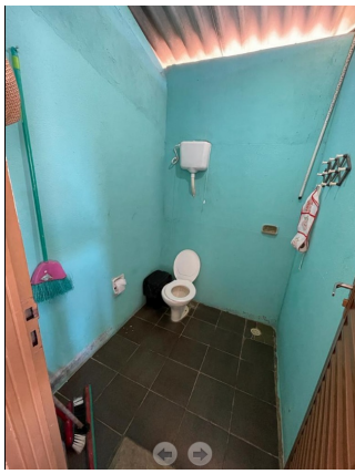
Banheiro sem acessibilidade
