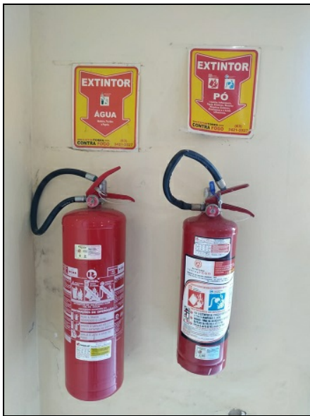
Extintores de incêndios com recarga vencida.
