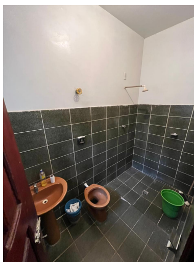
5. Banheiro sem acessibilidade.
