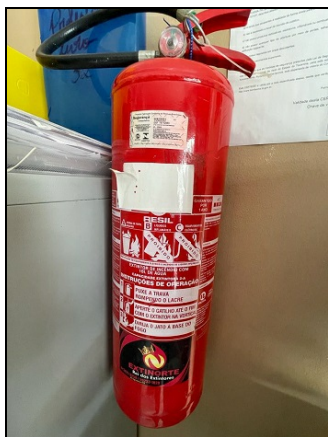
Extintor de incêndios irregular.
