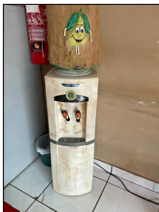
Bebedouro para os usuários inadequado.
