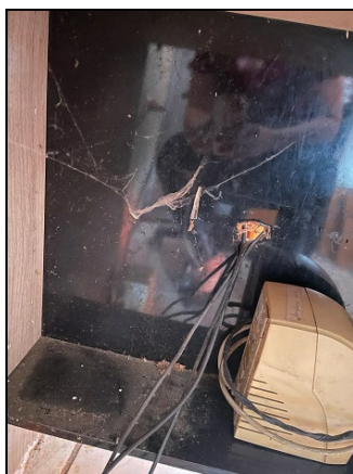
Situação sanitária irregular.
