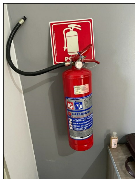
Extintor de incêndios sem o selo do Inmetro com os prazos de validade de recargas.
